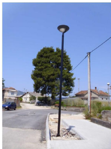
2.3.2. Čelični stup JR-2
