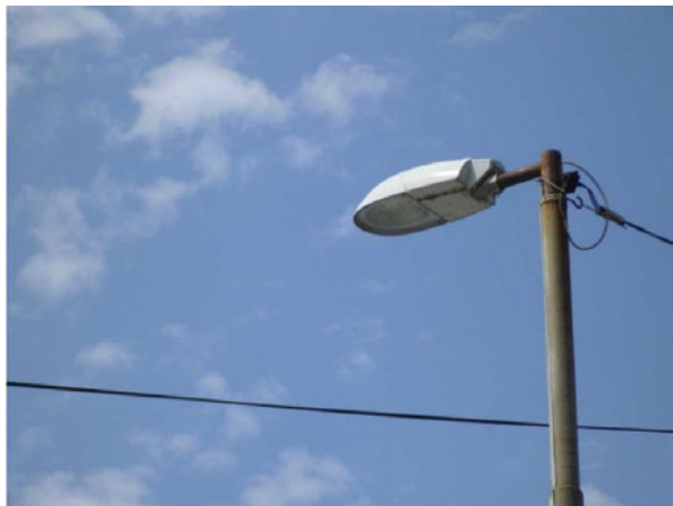
2.3.7. Stup oštećen korozijom-1
