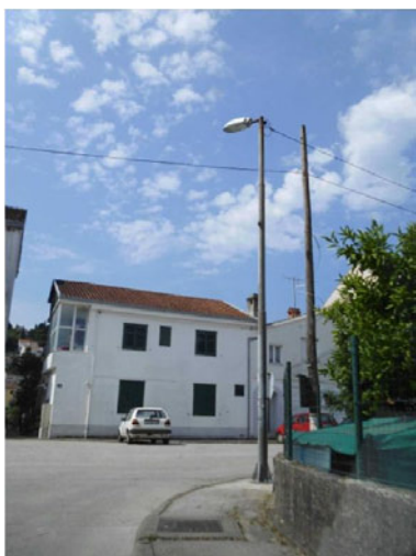
2.3.1. Čelični stup JR-1
