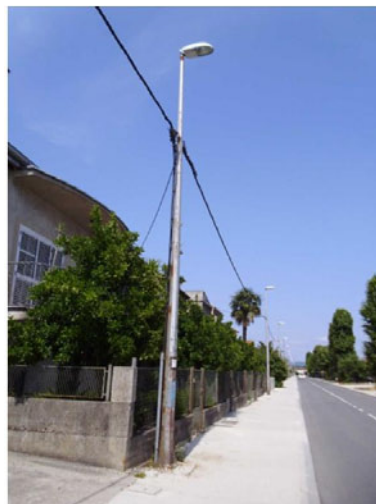
2.3.10. Stup oštećen korozijom-4
